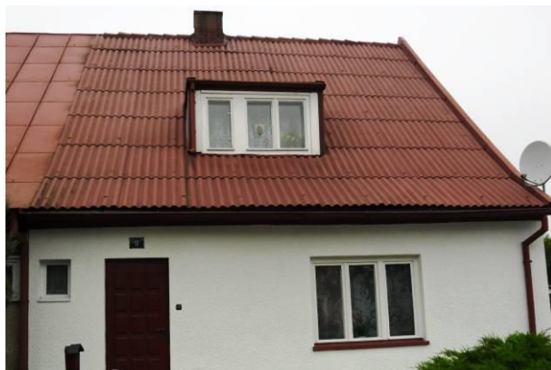
Rys. 6. Pokrycie dachowe ocenione w III stopniu pilności.
