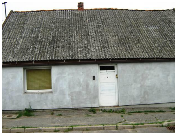
Rys. 7. Pokrycie dachowe ocenione w II stopniu pilności.
