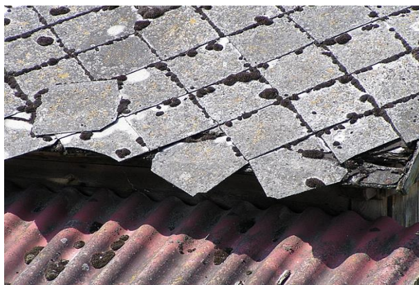
Rys. 8. Pokrycie dachowe ocenione w I stopniu pilności.
