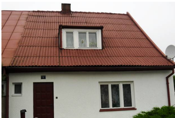
Rys. 6. Pokrycie dachowe ocenione w III stopniu pilności.
