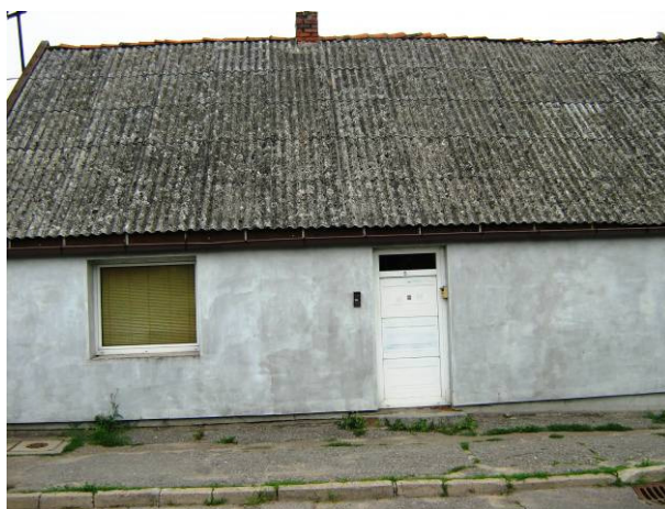
Rys. 7. Pokrycie dachowe ocenione w II stopniu pilności.
