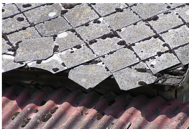
Rys. 8. Pokrycie dachowe ocenione w I stopniu pilności.
